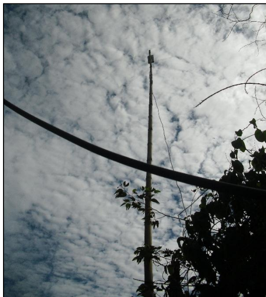
Figura. 4.4 Router instalado en nodo LAINEZ.
