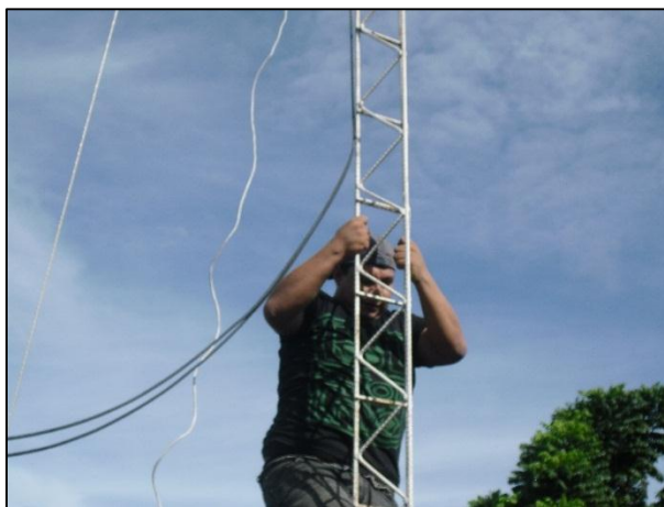
Figura. 4.1 Instalación del router en nodo WALEJO.
