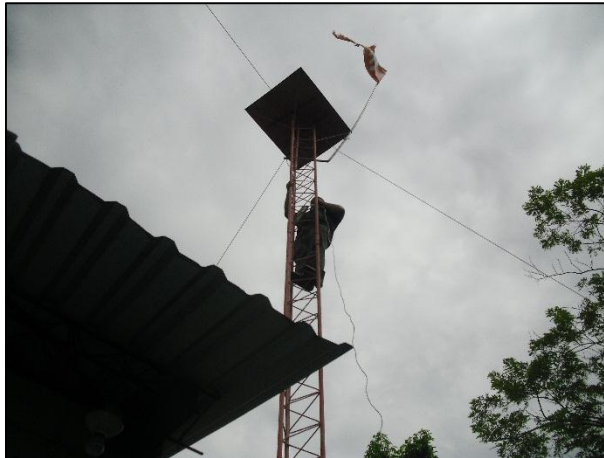
Figura. 4.13 Router instalado en el nodo repetidor CIBER.
