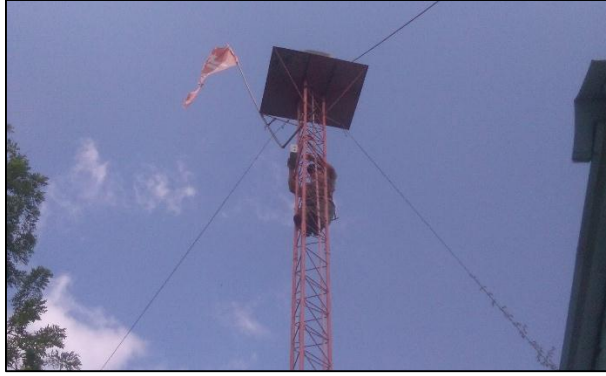
Figura. 4.26 Instalación del router en nodo CIBER.
