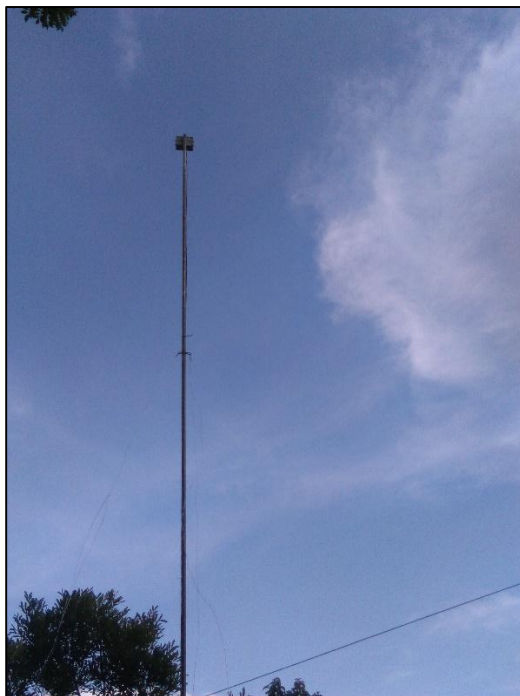
Figura. 4.28 Router instalado en nodo TORRES.
