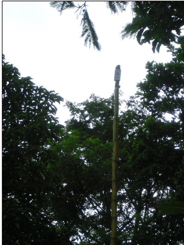
Figura. 4.15 Router instalado en el nodo TORRES.
