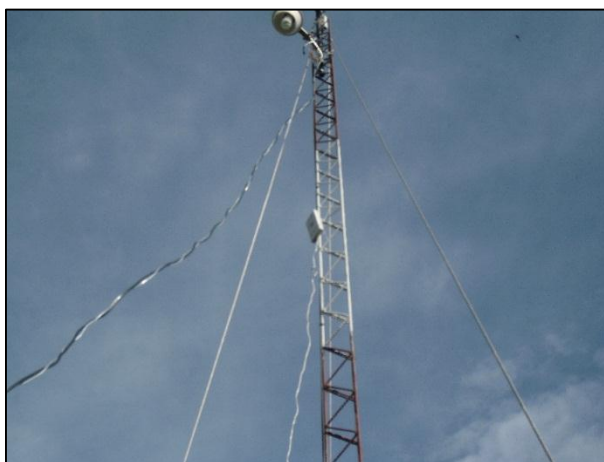
Figura. 4.2 Router instalado en nodo WALEJO.
