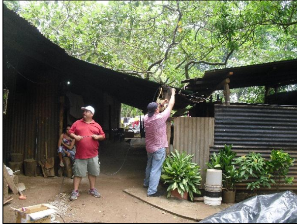
Figura. 4.10 Instalación del router en nodo LEIVA.
