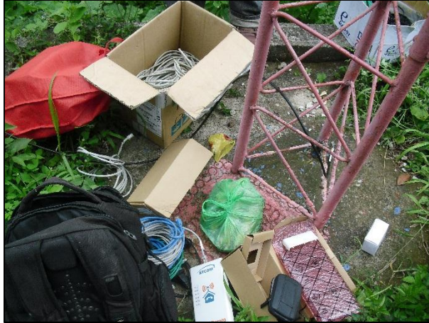
Figura. 4.12 Instalación del router en el nodo repetidor CIBER.
