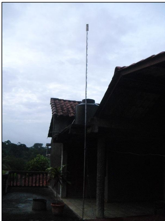
Figura. 4.5 Router NS2 instalado en el nodo TOÑO.
