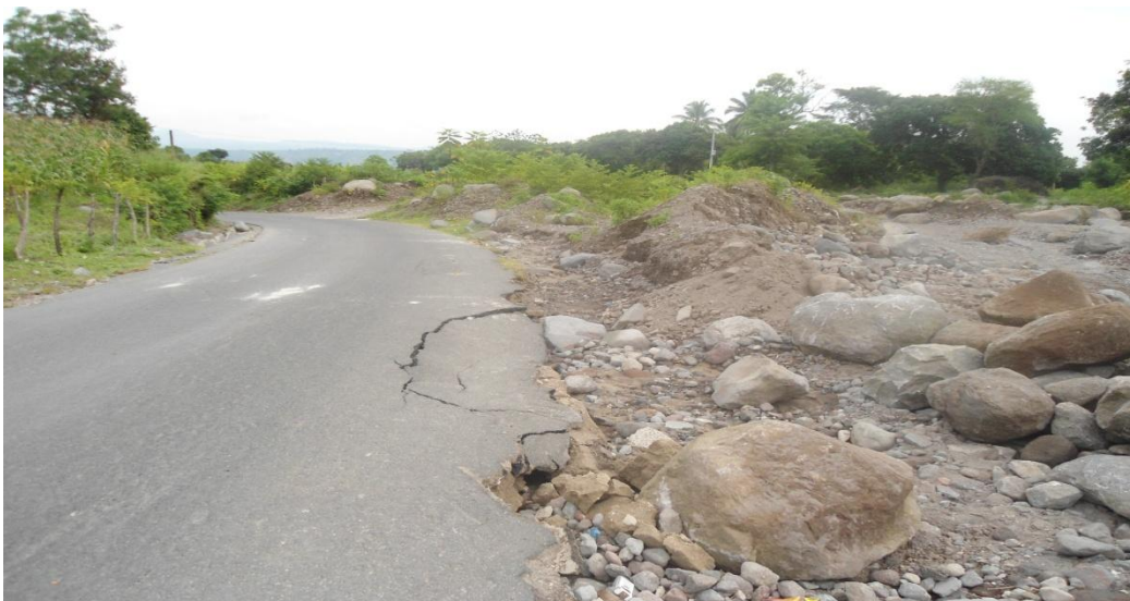
FOTOGRAFIA 2. Carretera hacia Santa María Ostuma y San Pedro Nonualco, además de ello es la principal vía de acceso que tiene las comunidades de la zona baja del municipio de Guadalupe, en el estudio la Colonia de Villa Santa Anita.
