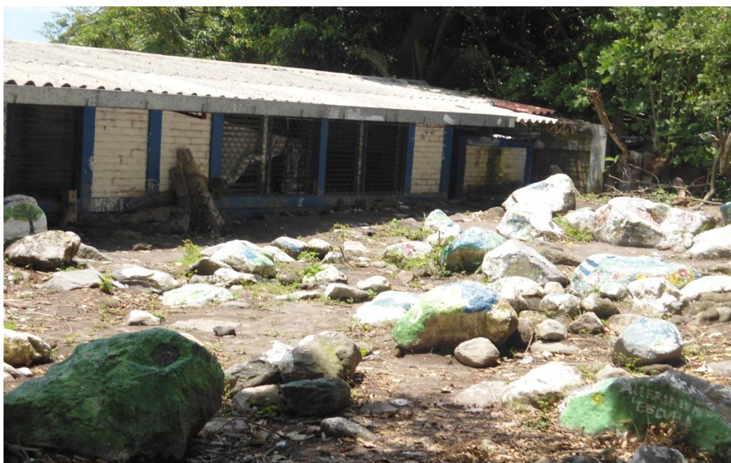
FOTOGRAFIA 6. Condición actual de la parte de atrás del Centro Escolar El Refugio, resultó dañada en su infraestructura con el paso de la Tormenta IDA, hasta el momento no se han realizado ninguna cambia desde esa fecha hasta hoy.
