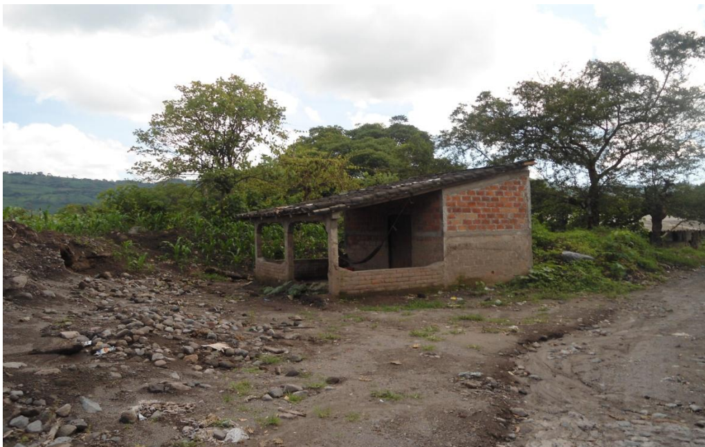
FOTOGRAFIA 5. Vivienda que pertenece a la Colonia El Zapotillo, Tepetitán, la cual resultó dañada con el paso de la Tormenta IDA.
