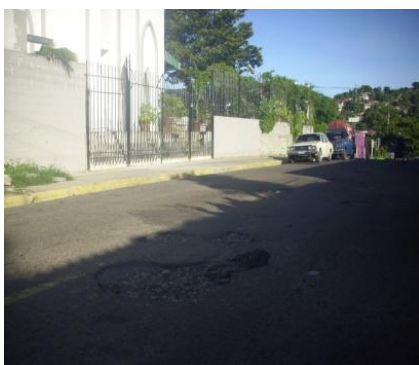
Fotografía 5: deterioro sobre Av. Principal, Municipio de Ayutuxtepeque
