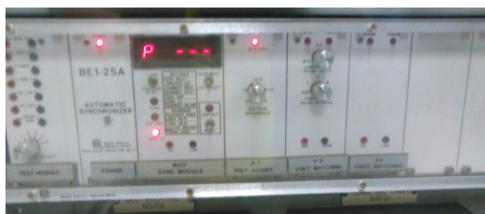
Figura 4.33. Fotografía de sincronoscopio en funcionamiento en Geotérmica de Berlín
