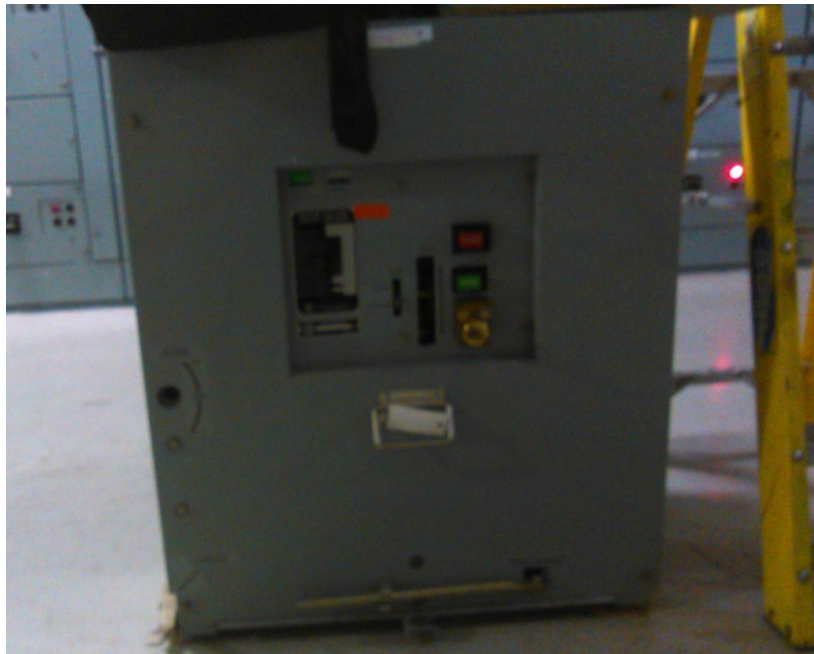
Figura 4.29. Fotografía de interruptor de potencia de 480V tomada en Geotérmica de Berlín
