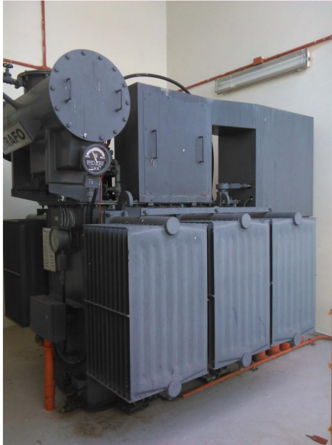
Figura 4.10. Fotografía de transformador auxiliar TGR de aceite en funcionamiento en Geotérmica de Berlín
