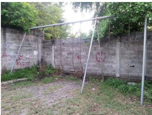
Juegos recreativos en evidente deterioro, ubicados en colonia jardines del Volcán, San Miguel.
