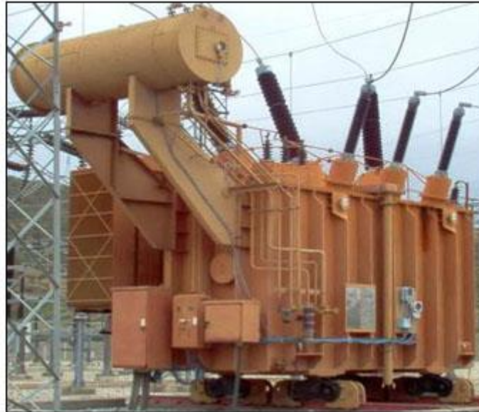
Figura 4 Cuba de un transformador de potencia 6
