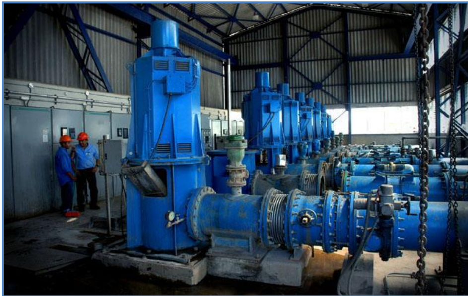
Figura 2.4 Sistema de bombeo en bocatoma de planta potabilizadora Las Pavas.
