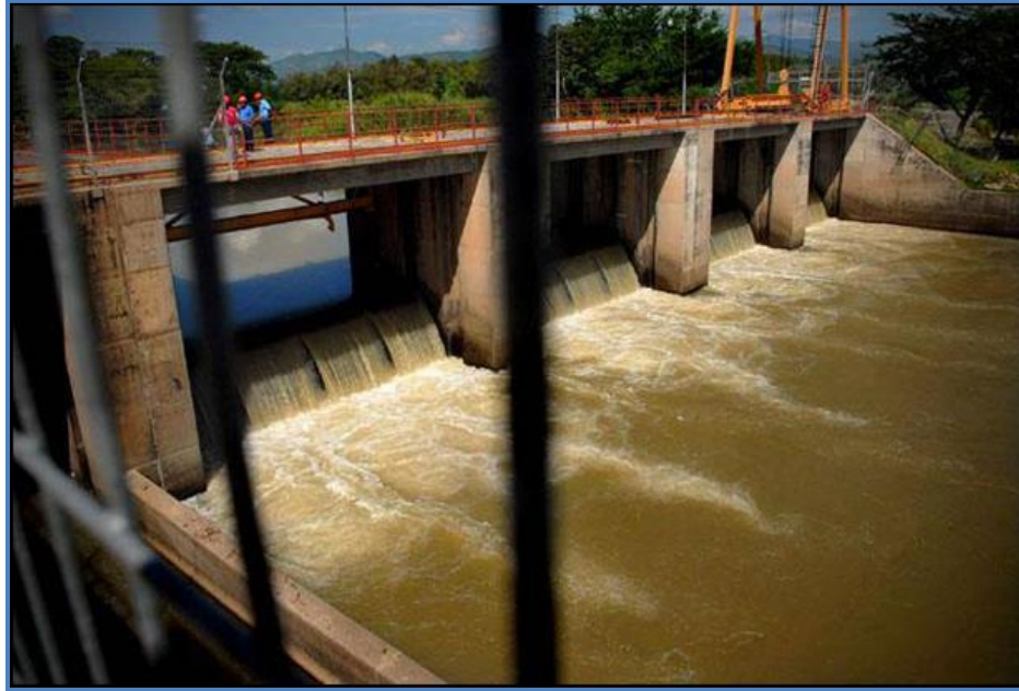
Figura 2.3 Esclusas en bocatoma de planta potabilizadora Las Pavas.
