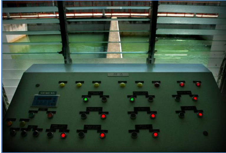
Figura 2.7 Control de sistema de filtración en planta potabilizadora Las Pavas.
