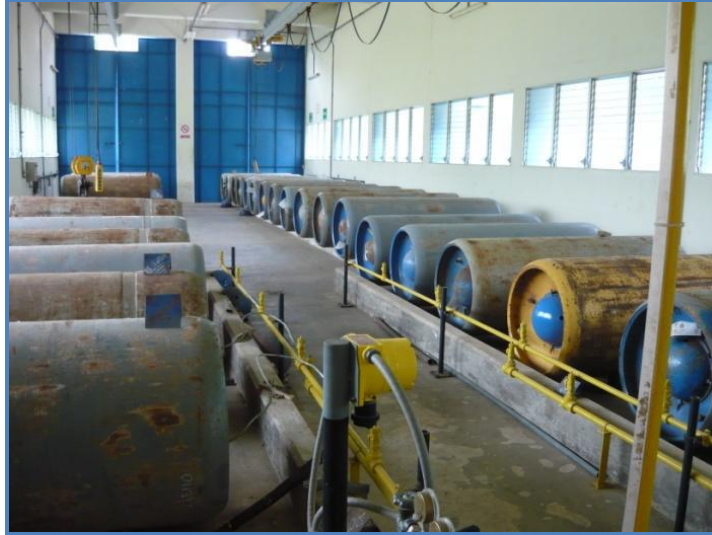
Figura 2.8 Sistema de dosificación de cloro en planta potabilizadora Las Pavas.
