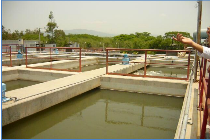
Figura 2.6 Sistema de sedimentado en planta potabilizadora Las Pavas.
