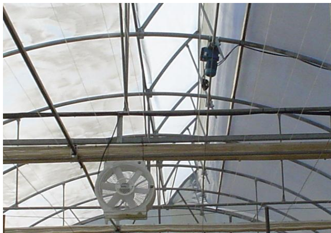
FOTO 15: SISTEMA DE VENTILACIÓN
