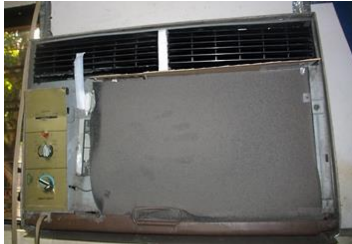
Figura 3.2-3. Aire acondicionado tipo ventana instalado en el cubículo de docentes.
