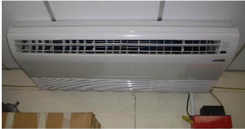
Figura 3.2-1. Aire acondicionado tipo split instalado en el laboratorio de telemática.
