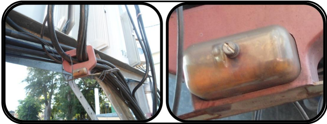
Figura 18 Borneras de bobina de corriente con oxido.
