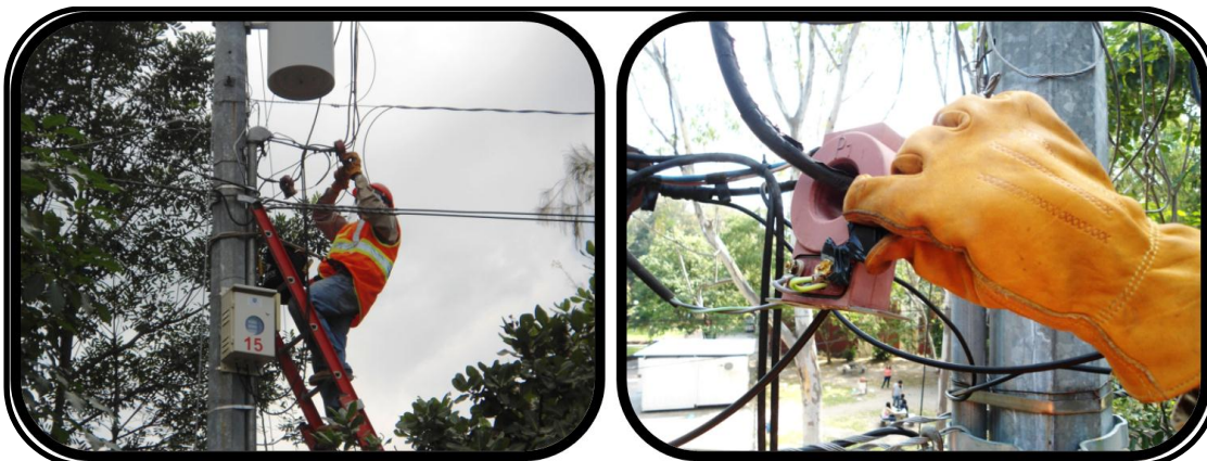
Figura 10 Mantenimiento de bobinas de corriente en poste.
