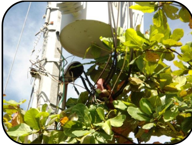
Figura 21 Medidor y bobinas de corriente cubiertos por ramas.
