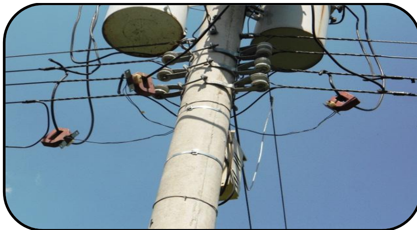
Figura 2 Medidor fuera de servicio montado en poste.
