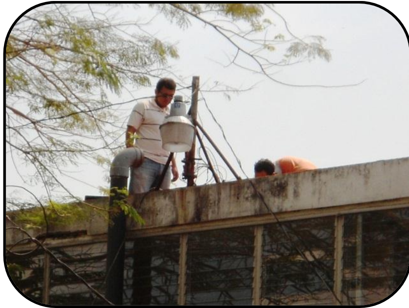
Figura 5 Alumnos en labor de corrección de falla sin equipo anti-caídas.
