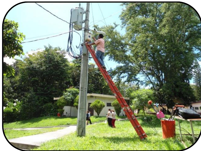
Figura 6 Acción de mantenimiento sin ninguna norma de seguridad.
