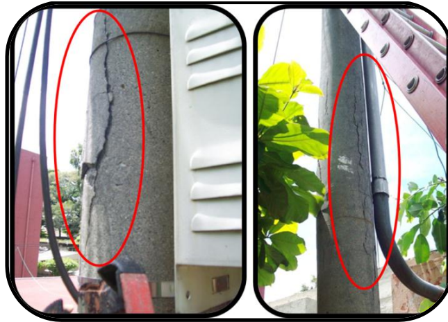
Figura 15 Medidor en poste rajado.
