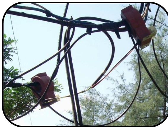
Figura 20 Cables de bobina de corriente tensos.
