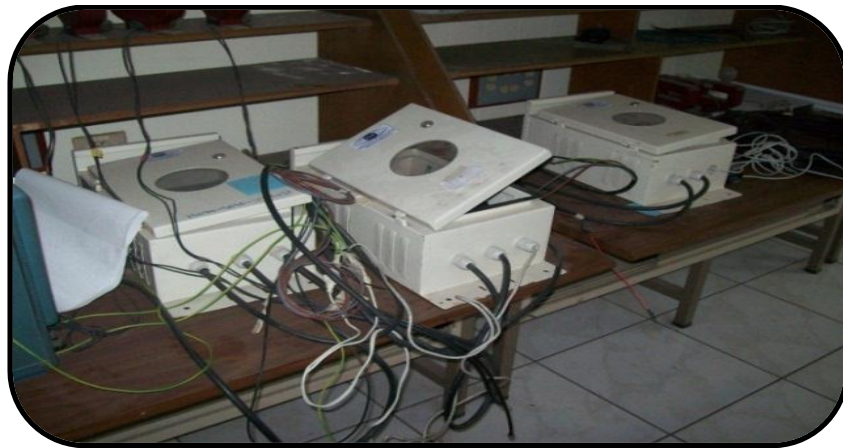
Figura 1 Medidores fuera de servicio depositados en laboratorio.
