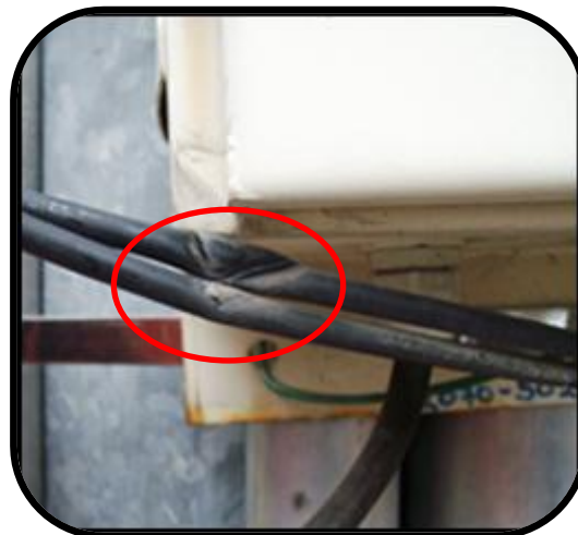
Figura 17 Cable UTP dañado.
