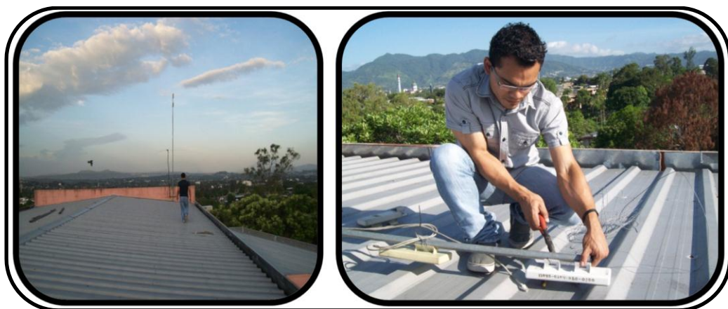
Figura 4 Realizando labor de mantenimiento correctivo sin equipo de protección.
