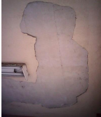
Pasillo Segunda Planta Edificio B, Techo despegándose
