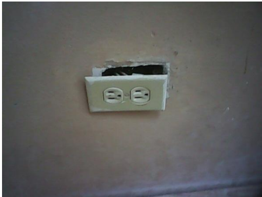
Toma corriente despegado
