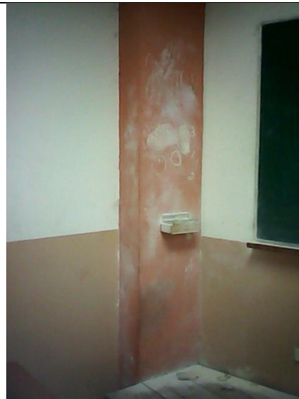
Paredes manchadas y exceso de acumulación de tiza
