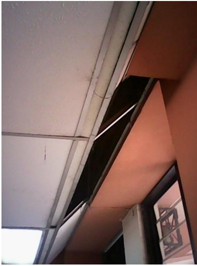
Falta cielos falsos
