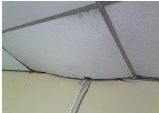
Riesgo Físico por desplome de cielo falso. (pasillos de la tercera planta).
