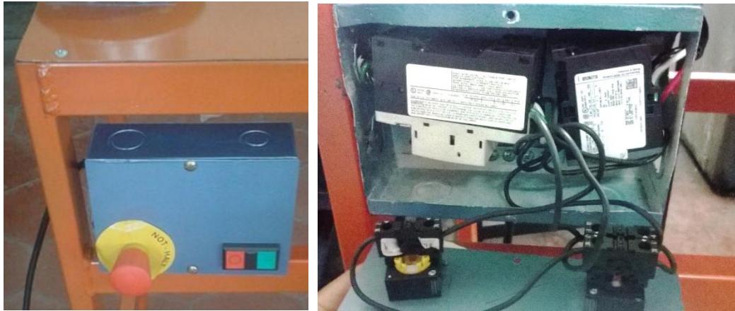
Fig.2.8. Panel de control, vista exterior e interior.
