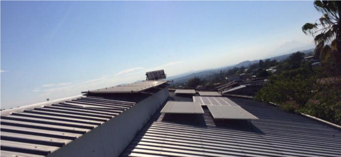
Ilustración 99: Sistema fijo en techo de la escuela de ingeniería eléctrica
