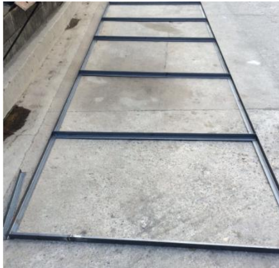
Ilustración 48: Marco soporte de los páneles solares.
