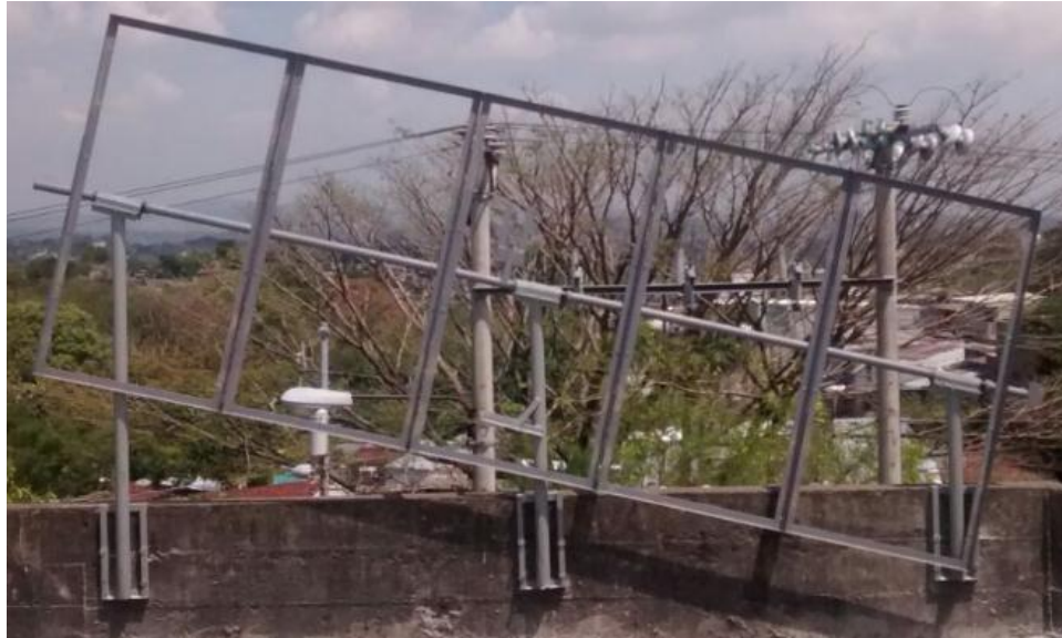
Ilustración 52: Estructura fijada al techo de Edificio de Potencia.
