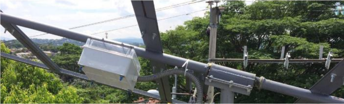
Ilustración 54: Sistema de control fijado en el eje.
