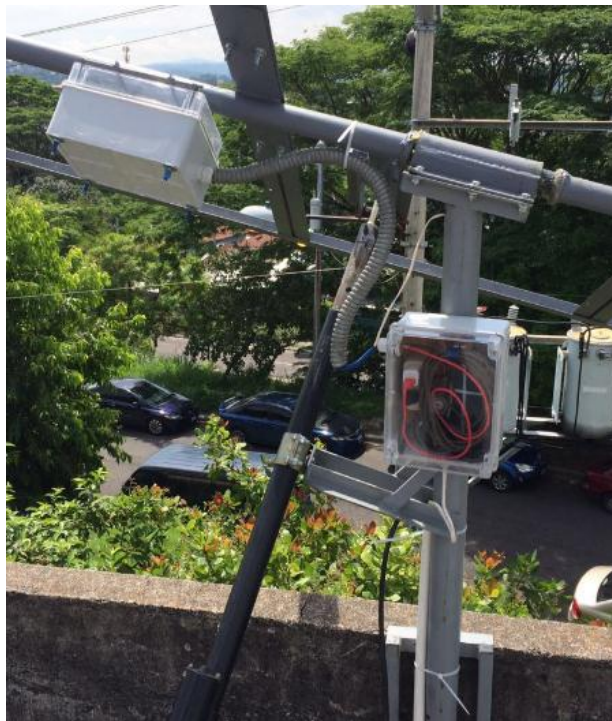
Ilustración 55: Sistema de control automático y etapa de potencia.
