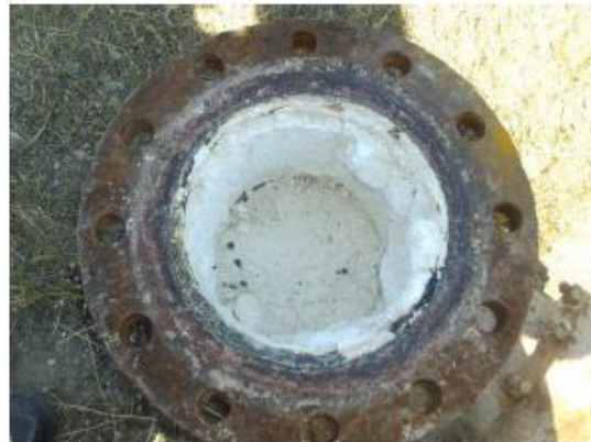
Figura 4.2 Obstrucción por incrustación de Calcita en un segmento de tubería.
