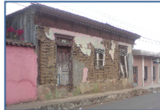
Viviendas Antiguas Muy Deterioradas
