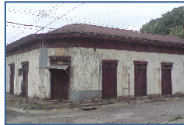
Viviendas Antiguas levemente Deterioradas
