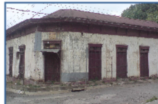
Viviendas Antiguas levemente Deterioradas
