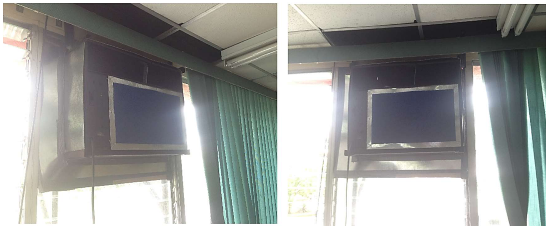
Fig. 3.5. Equipos de aire acondicionado instalados
