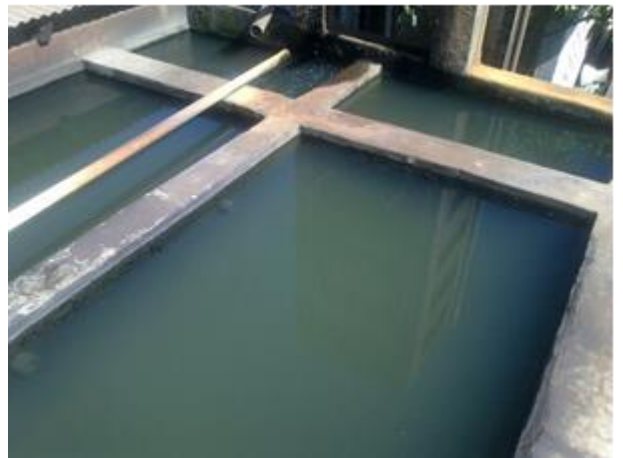
Sedimentado de los flóculos formados.
