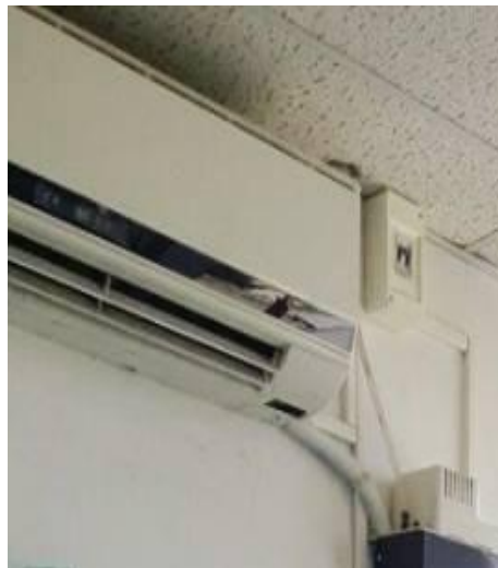
Figura N° 7. Aire acondicionado tipo mini split
