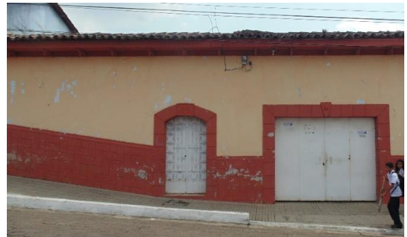
Ilustración 156: Vista Frontal de acera existente en tramo inicial de la avenida Roberto carias, Izalco.
