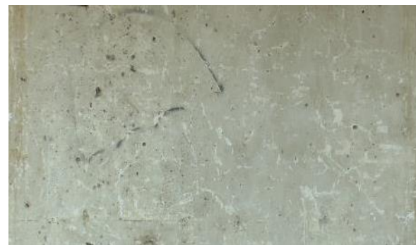
Ilustración 143: Este tipo de fisuras son producidas por movimientos de dilatación-contracción, por temperatura, en los enchapados, y por retracción, en los morteros.
