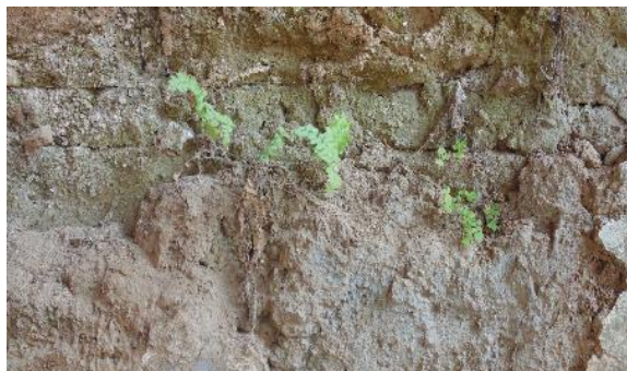
Ilustración 150: Degradación en materiales causado por plantas, que segregan sustancias que alteran la estructura química del material.
