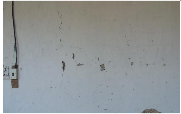
Ilustración 142: Grieta observada en cruja oeste, generalmente este tipo de daños se forman en los elementos estructurales, cuando son sometidos a cargas que superan la resistencia a los esfuerzos de los materiales.
