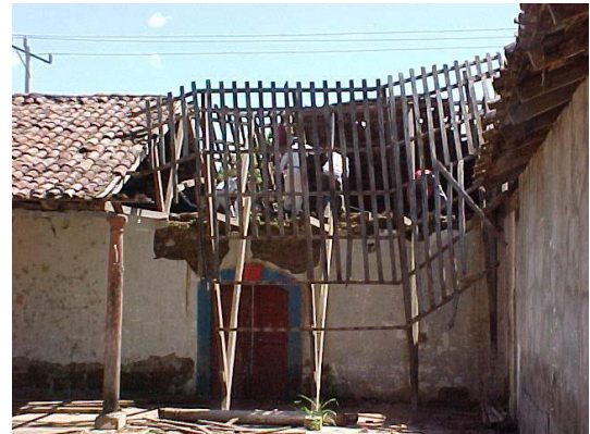
Ilustración 151: Colapso de cubierta en crujía Norte, sobre puerta 8, Casa Barrientos 2001. Fuente: Caracterización de Daños en construcciones de Adobe, Daniel Torrealva Dávila, junio 2003, Foto M. Hardy.
