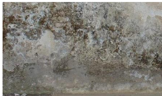
Ilustración 139: Transformación de la superficie de repello, producido por agentes erosionantes como el agua, o cambios de temperatura.
