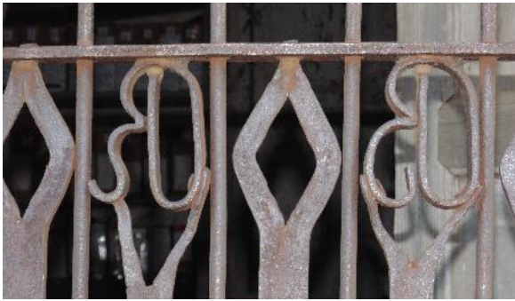
Ilustración 148: Corrosión es el ataque destructivo de un metal por reacción química o electroquímica con su medio ambiente.
