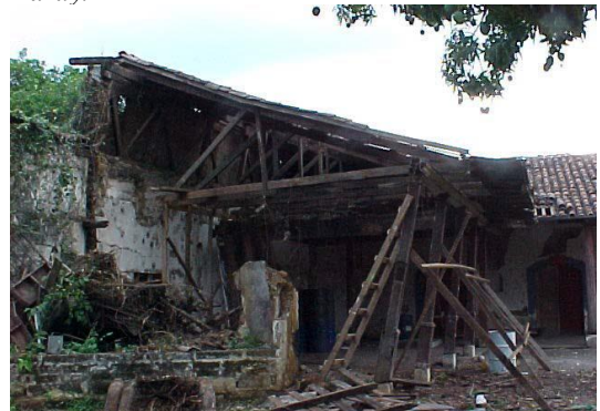
Ilustración 152: Corredor Sur, Techo pesado apoyado sobre un muro de adobe y columnas de madera, en precario estado de equilibrio. Casa Barrientos, 2001. Fuente: Ídem.
