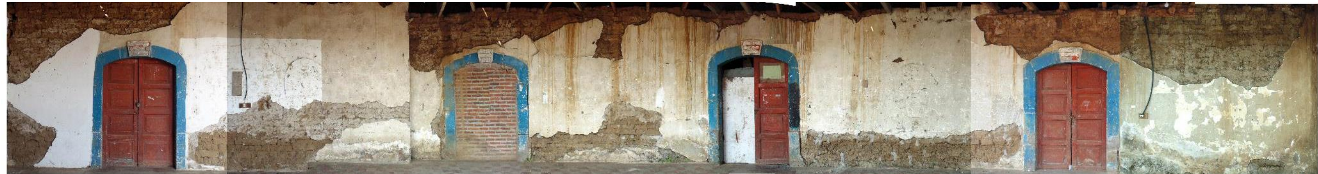
Ilustración 100: Elevación Corredor Norte, Eje 2 , cuenta con 4 vano de puertas reforzados con marcos de piedra, uno de ellos sellado con ladrillo de barro cocido después del terremoto de 2001.
