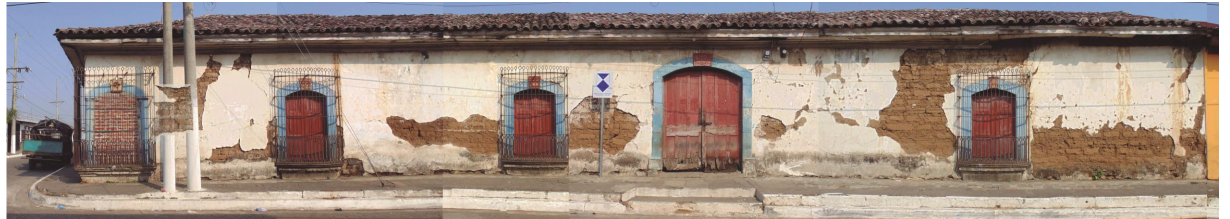
Ilustración 97: Elevación Oeste, Eje A , con cuatro ventanas y el único vano de acceso, aún conserva la mayoría de su cornisa que según relatos y escritos desde hace 50 años estaba pintada de color verde derivado del añil, las paredes siempre han tenido el blanco característico de la cal, el tinte para paredes de adobe comúnmente utilizado.
