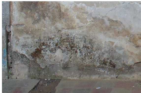
Ilustración 146: Descomposición de sales solubles, que son llevadas por el agua hacia el exterior durante su evaporación y cristalización en la superficie del material.
