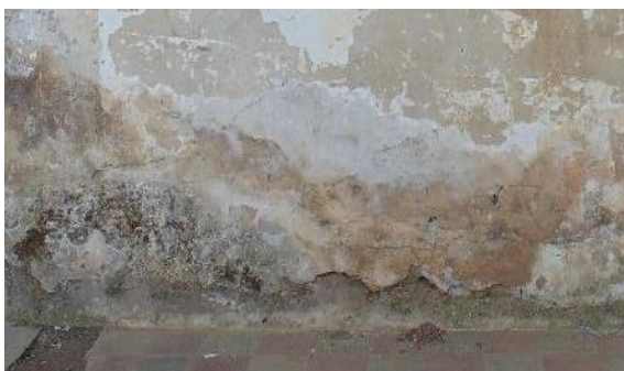
Ilustración 138: La presencia de humedad mayormente se genera en zona baja de paredes, muros y cimentaciones, lo que puede ocasionar variaciones de las características físicas y resistencia de los materiales.
