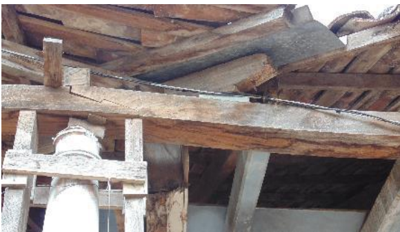
Ilustración 141: Viga deformada por pandeo, producido como consecuencia del exceso de cargas sometidas a esfuerzo del elemento.
