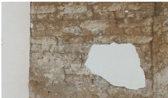
Ilustración 144: Separación entre un material de acabado y el soporte al que está aplicado por falta de adhesión entre dos superficies.
