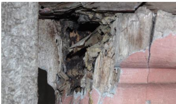
Ilustración 149: Degradación de madera de columna por presencia de insectos que se alojan al interior del material.
