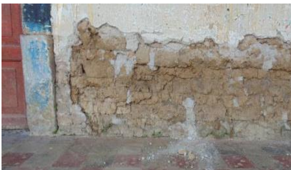
Ilustración 145: Pérdida de repello en pared, por erosión mecánica, ocasionada por golpes o rozaduras en la parte inferior de la pared.
