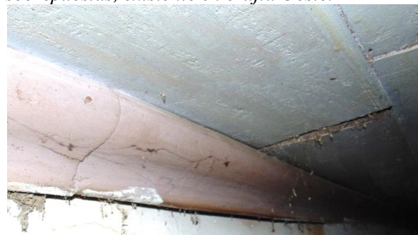
Ilustración 118: Moldura Tipo 01 de madera pintada con pintura acrílica base agua, se ubica en el perímetro del Cielo Tipo 01
