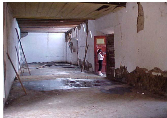
Ilustración 153: Crujía Norte, Humedad en parte baja de muro con disminución de sección transversal. Casa Barrientos, 2001. Fuente: Ídem.
