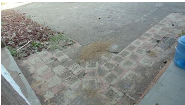
Ilustración 133: Piso de cemento simple de colores rojo y gris, en corredores y perímetro de patio central enmarcando adoquinado en área antiguamente cubierta por vegetación.
