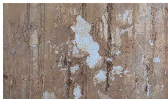
Ilustración 140: Suciedad producida por partículas que penetran en el poro superficial del material por la acción del agua lluvia y que tiene como consecuencia más característica churretones, mejor conocida como lavado diferencial, visibles en fachadas y paredes o muros expuestos a la intemperie.
