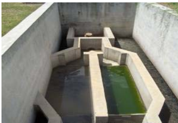
Figura 2.3 Tanque de separación de Sólidos y Líquidos
