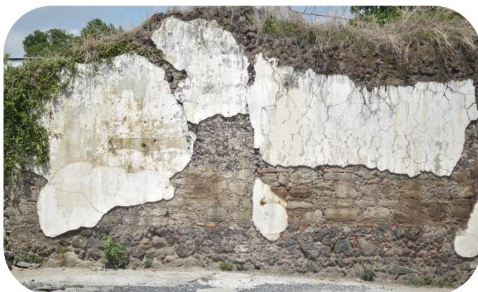
Muro deteriorado de la ciudad de santa tecla 2015
