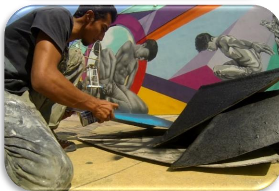
Aplicación de base automotriz para sellar los poros de la fibra de vidrio Fuente: Raymond Barrera Imagen N° 101, 102
