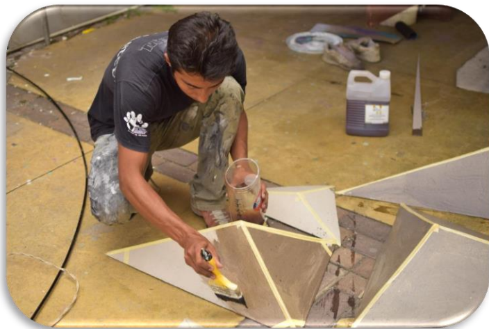
Mauricio Morales en el proceso De aplicación de la primera capa de resina Fuente: Raymond Barrera Imagen N° 96
