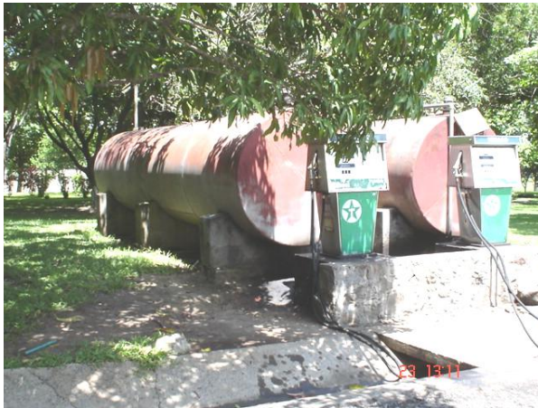
Figura 3.3.17: Tanques de combustible.
