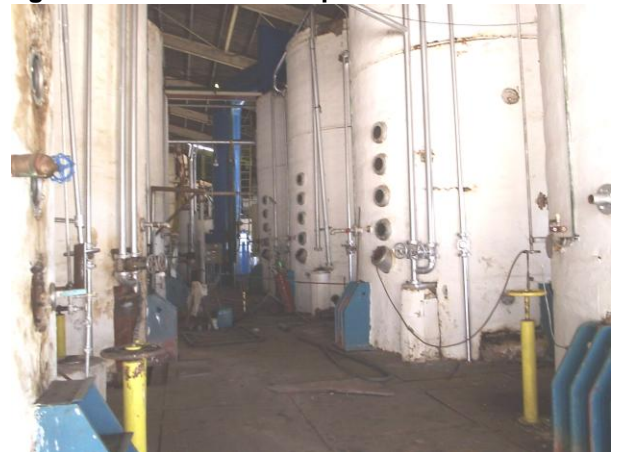
Figura 3.2.6: Área de Evaporadores.
