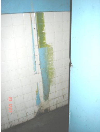
Figura 3.3.30: Baños sin puerta.
