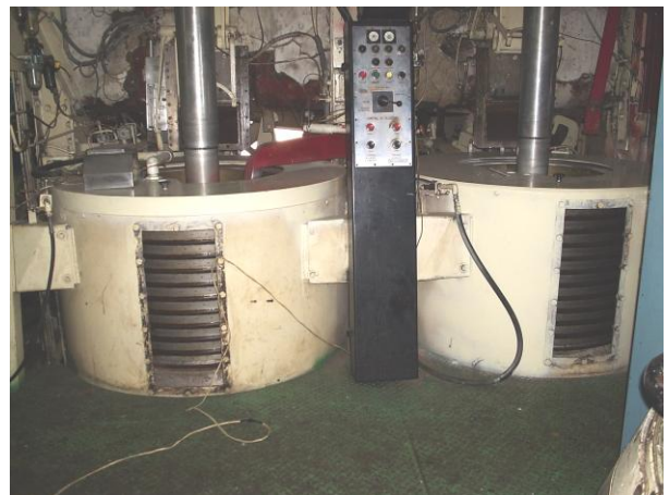
Figura 3.2.8: Área de Centrífugas
