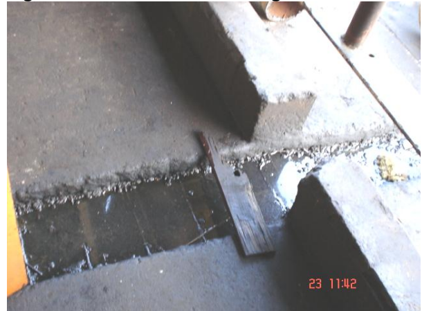
Figura 3.3.6: Canaleta de desagüe.
