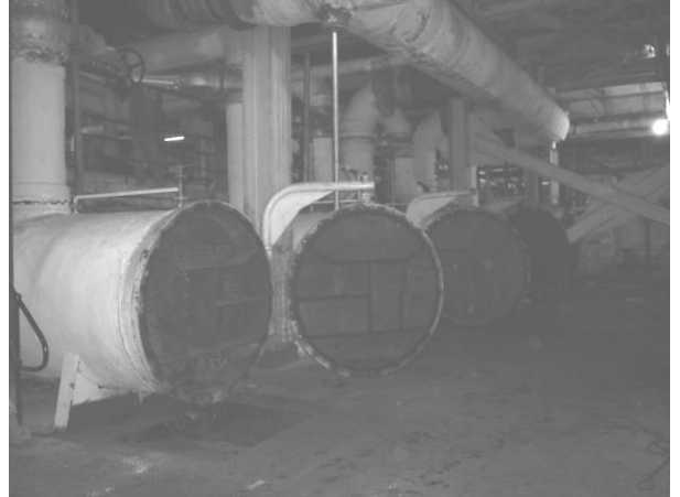
Figura 3.2.4: Área de Clarificadores
