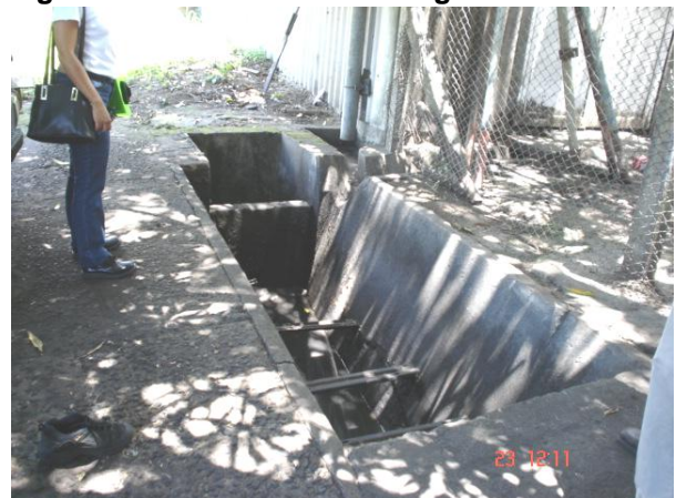
Figura 3.3.8: Canaleta de desagüe.
