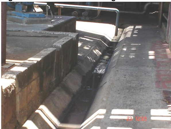
Figura 3.3.7: Canaleta de desagüe.
