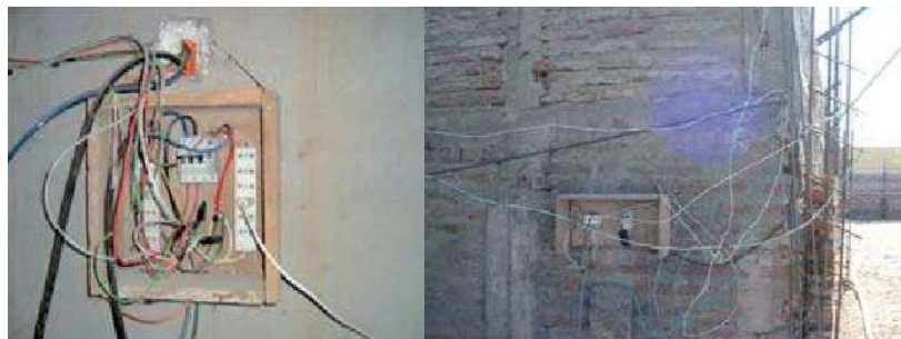
Figura 2.4 Ejemplo de malas instalaciones eléctricas.
