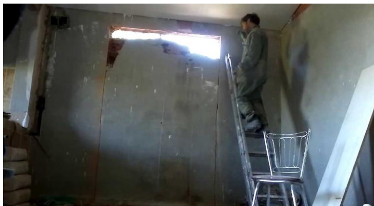
Figura 2.9 Al no respetar lo indicado en los planos y seguir con la construcción, se mayorizan los errores. Ejemplo, desplome de pared; repello ondulado, etc.
