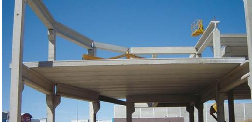
Figura 4.3 Colocación de placa alveolada. Como se muestra en la imagen la placa abarca una gran luz.
