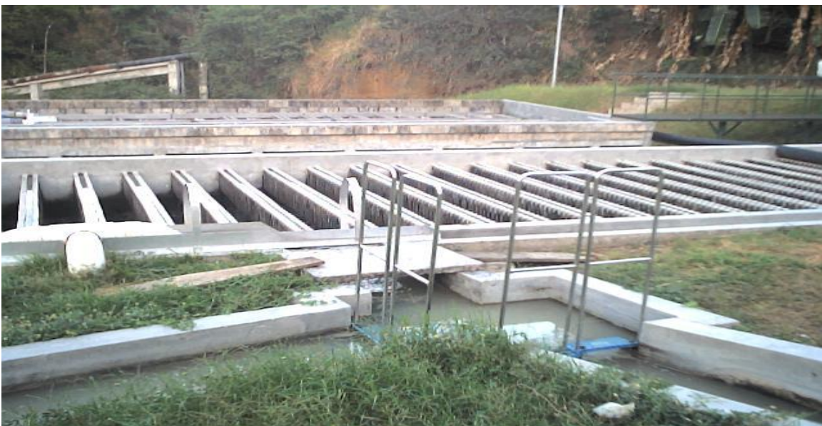
Fig. 3.2.1.4 Filtro biológico donde se realiza la remoción de materia orgánica mediante la activadas bacterias que se esta alojando en la escoria volcánica, que permite la circulación del aire y la eliminación natural de la materia orgánica.
