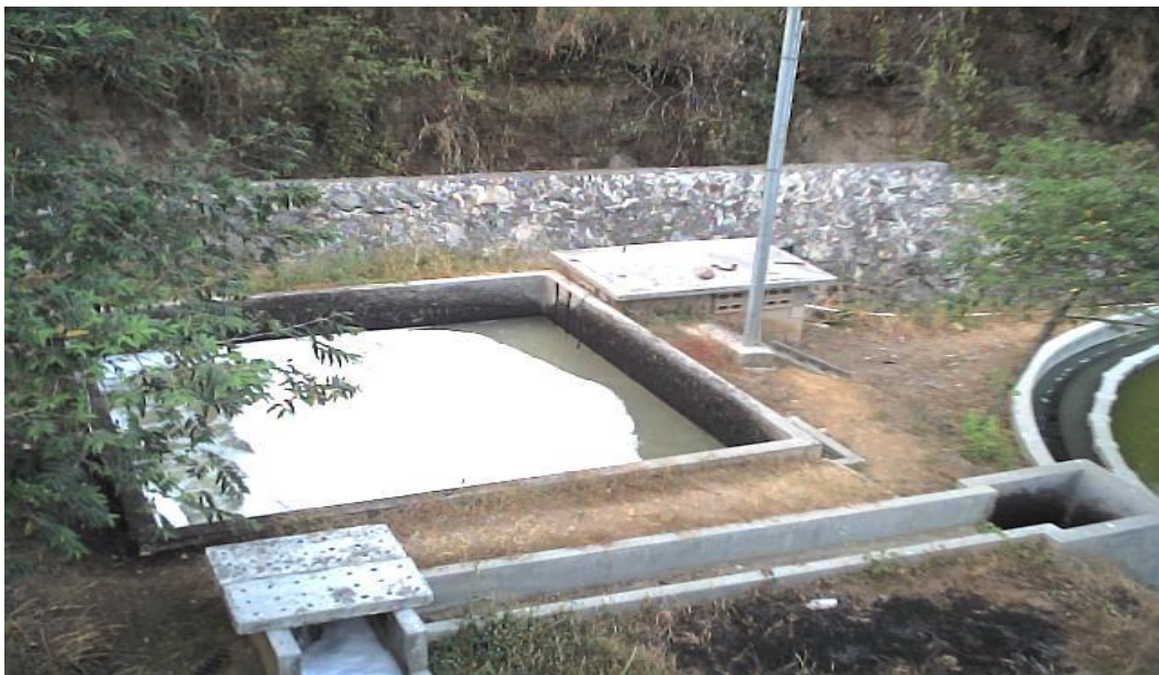
Fig. 3.2.1.2 Tratamiento de aguas residuales de la planta de Santísima Trinidad en la primera etapa de tratamiento primario físico.
