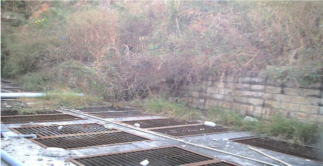
Fig. 3.2.1.6 Planta de tratamiento de Alto del Escorial que se observa sin mantenimiento de tipo de lodos activados.
