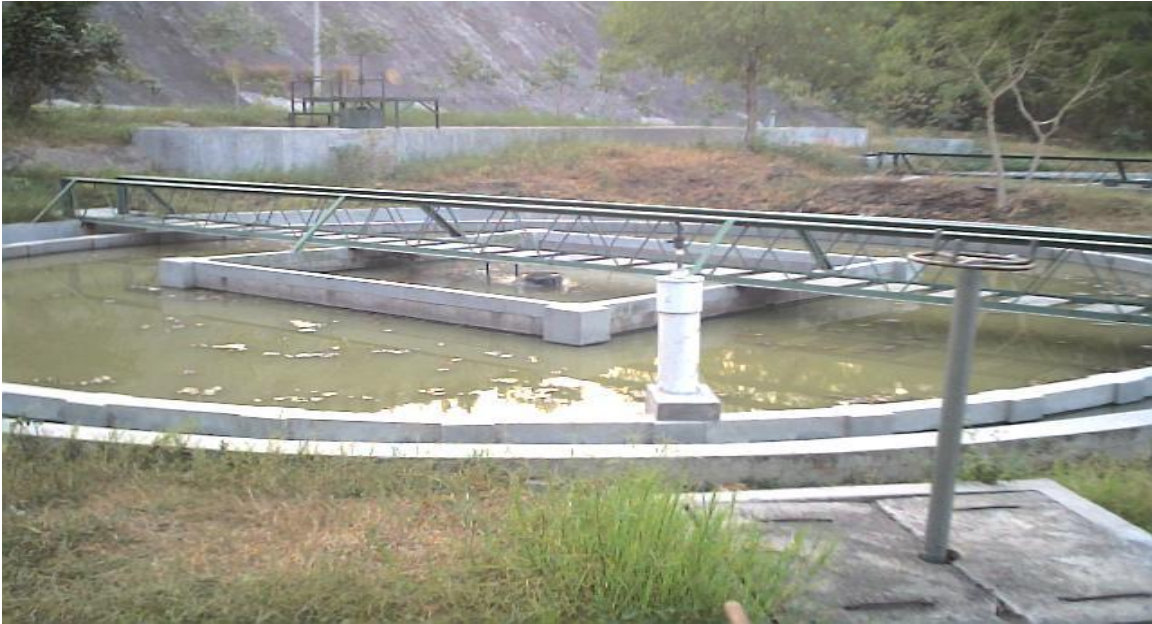
Fig. 3.2.1.3 Sedimentador primario de la planta de Tratamiento Santísima trinidad, sólidos en suspensión que son depositadas en los helechos o secado de lodos.
