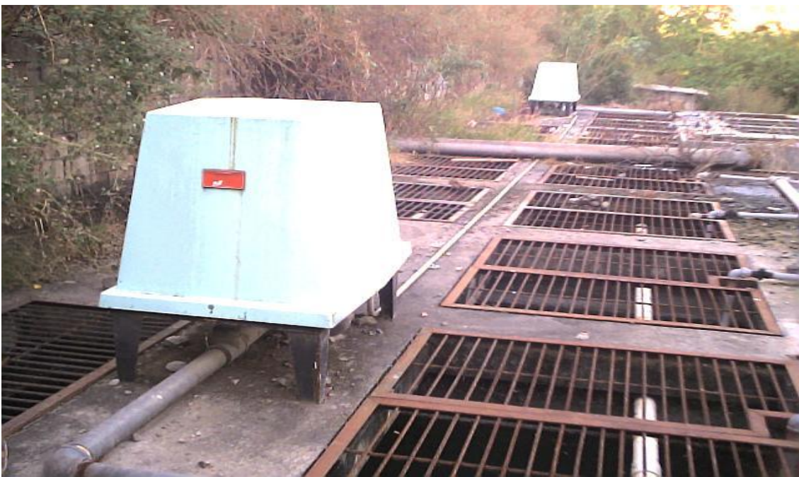
Fig.3.2.1.5 Planta de tratamiento de la colonia Altos del Escorial, del tipo lodos activados en funcionamiento, un motor y el otro con desperfectos.
