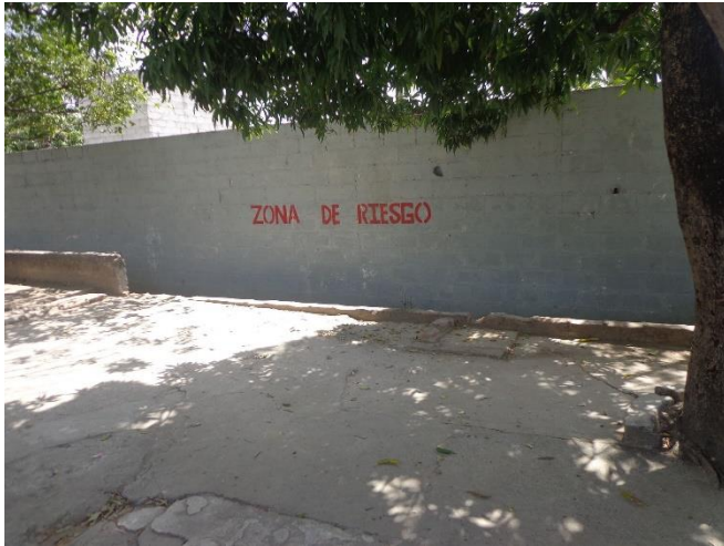
Señalización de zonas peligrosas al interior del Complejo Educativo.
