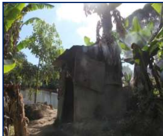
Casetas de letrinas en mal estado
