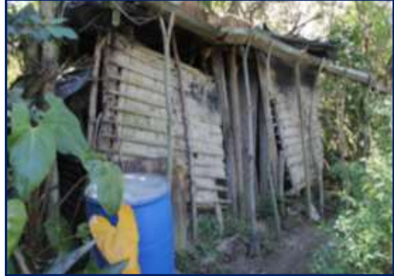
Techos de viviendas inadecuados, para la captación de agua lluvia
