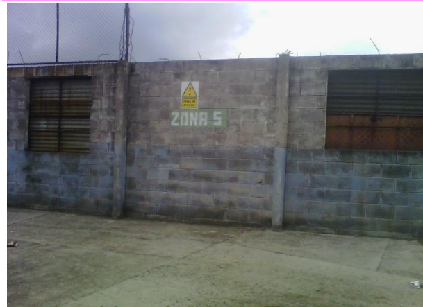
Señalización para cuidado de zona e identificación de riesgo
