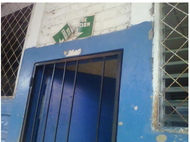
Señalización de zona en mal estado.
