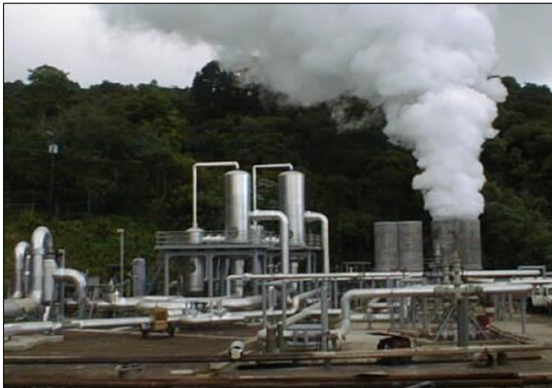
Fig. 19 Distribución de equipo separador y tubería de acarreo en plataforma DG-01.
