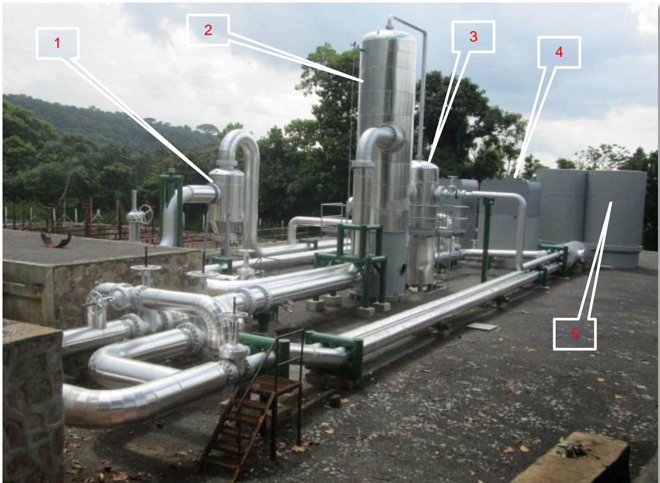
Fig. 11 Imagen de una estación de separación de flujo bifásico. 1. Tanque de bola, 2. Separador ciclónico, 3. Tanque de agua, 4. Silenciador de roca, 5. Silenciador atmosférico.
