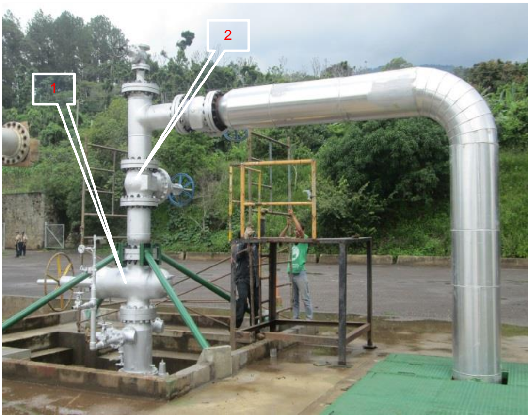
Fig. 12 Arreglo de un árbol de contrapozo geotérmico. (1) válvula maestra y (29) válvulas de control
