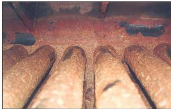
Figura 10. Tubos de humo de caldera con incrustaciones.
