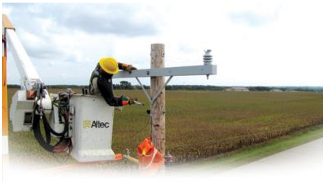
Figura 11. Crucero de fibra de vidrio instalado en poste de madera.
