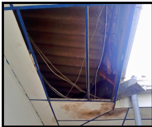
Techo en malas condiciones
