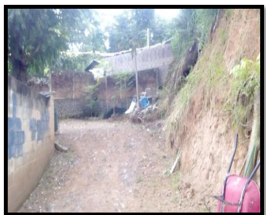
Riesgo de derrumbe por alud de tierra
