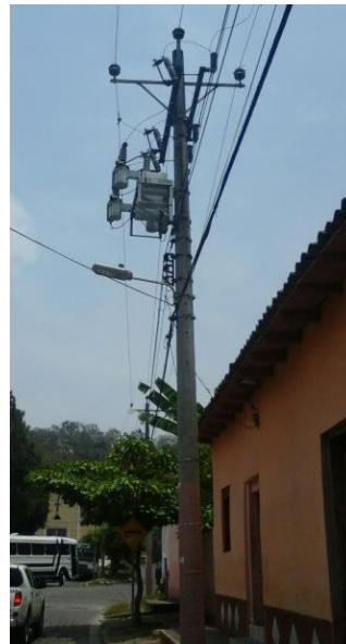
Foto MU-26: Poste eléctrico Fuente: Grupo de trabajo
