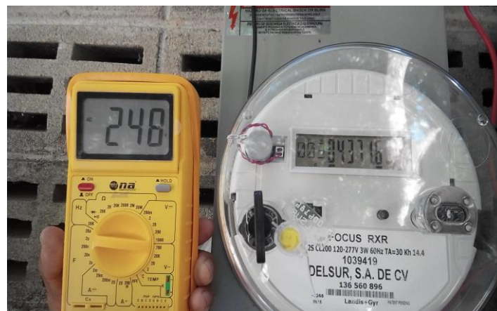
Figura 3.13: Lectura de voltaje línea a línea
