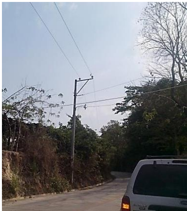
Imagen N° 18: Vista de poste y tendido eléctrico sobre calle cuesta El garrobo Fuente: Fotografía tomada en el lugar en abril 2016
