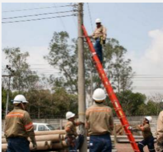
Fotografía N°64: Suministro de energía
