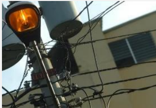
Fotografía N°65: Suministro de energía
