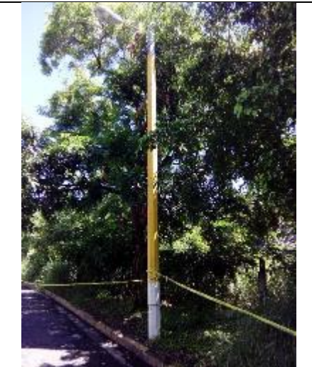
Fotografía 4: Luminaria lateral con brazo ó tipo bandera
