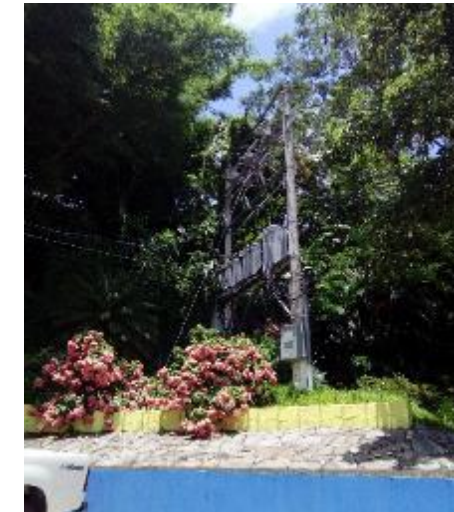
Fotografía 1: Se encuentra como única sub-estación eléctrica a un costado de la DIDOP y auditorio edificación principal del sector 3.
