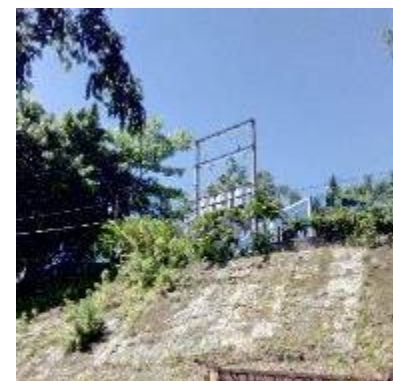
Fotografía 2: Sub estación en zona de VMVDU
