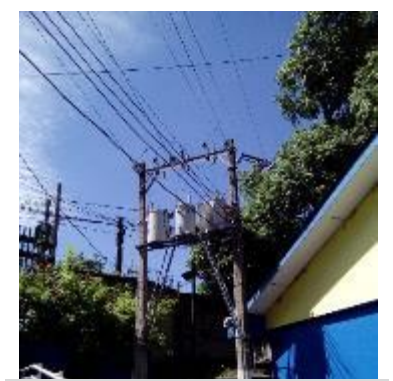
Fotografía 3: Sub estación cercano a entrada principal
