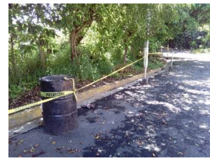
Fotografía 2: Delimitación de colindancia con cinta de PRECAUCIÓN por inestabilidad de terreno.
