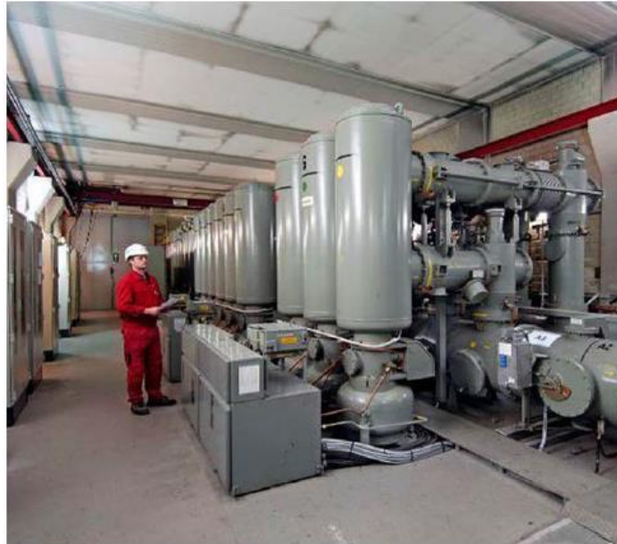
Figura 3 Subestación de Wittenau para una tensión nominal de 110 kV.
