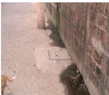
Fotografía 26: Medidor de A. P. en 1° calle Poniente Fuente: Toma Fotográfica Propia
