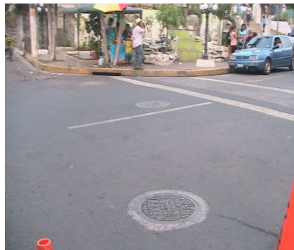
Fotografía 23: Pozo de A.LL. Y Pozo de A.N. en Avenida Norberto Morán Fuente: Toma Fotográfica
