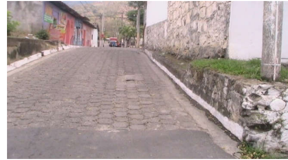
Fotografía 11: Desnivel en parte lateral del Edificio Municipal 1° calle Poniente Fuente: Toma Fotográfica Propia
