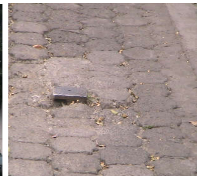
Fotografía 25: Llave de Control de A. P. en 1° Calle Pte. Fuente: Toma Fotográfica Propia
