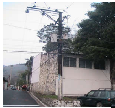
Fotografía 24: Poste de Energía Eléctrica en Ave. Eliseo Mijango Fuente: Toma Fotográfica Propia
