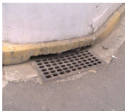
Fotografía 27: Parrilla de Caja Tragante de A. LI. en Ave. Norberto Morán Fuente: Toma Fotográfica Propia
