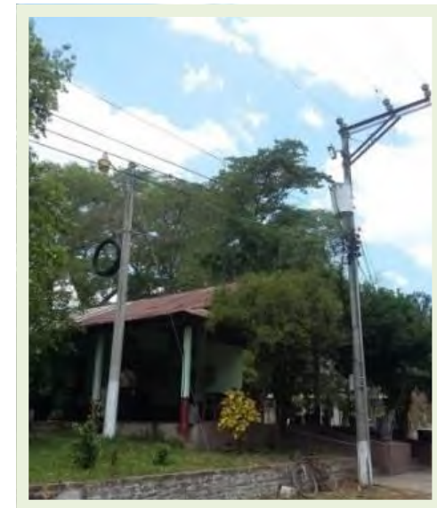
IMAGEN 55: POSTE DE ENERGÍA ELÉCTRICA, UBICADA EN EL LOTE EL CASCO.
