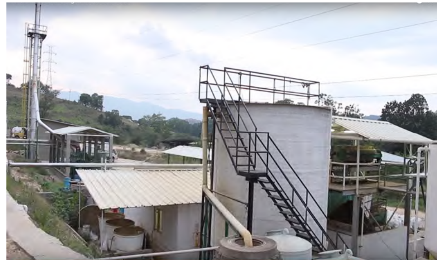
IMAGEN 41: PLANTA DE TRATAMIENTO EN FRIGORIFICO RIO FRIO S.A.S. , SANTANDER, COLOMBIA.
