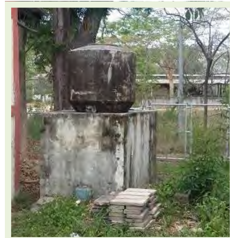
IMAGEN 54: TANQUE DE CAPTACIÓN DE AGUA
