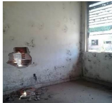
IMAGEN 44: Daños en las paredes
