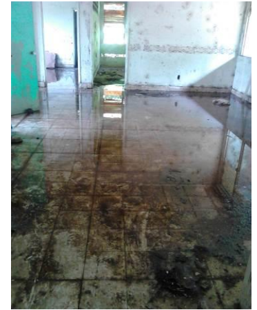
IMAGEN 46: por la ausencia de ventanas el agua ingresa al edificio
