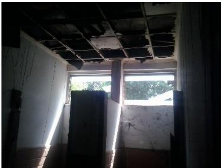
IMAGEN 43: Cielos falsos en muy mal estado
