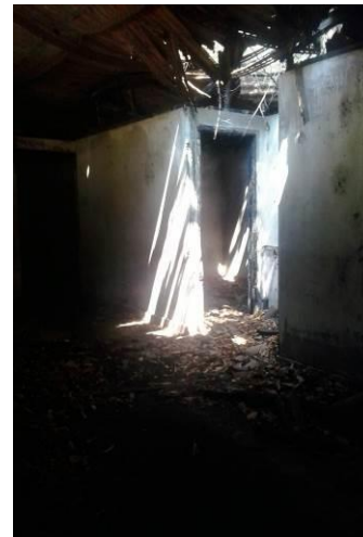
IMAGEN 47: Techos en mal estado
