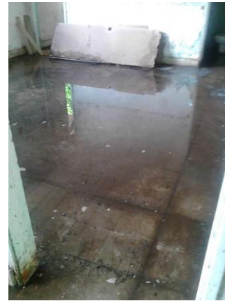
IMAGEN 45: Inundaciones dentro de la edificación provocando la filtración de agua en la estructura
