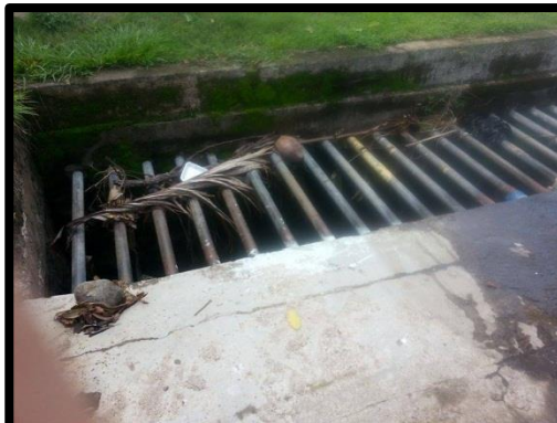
Recibidero de aguas lluvias del parque y calles aledañas
