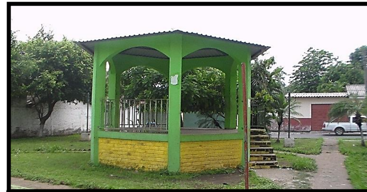
Kiosco, se observa un deterioro tanto en los barandales como en el repello y la pintura.
