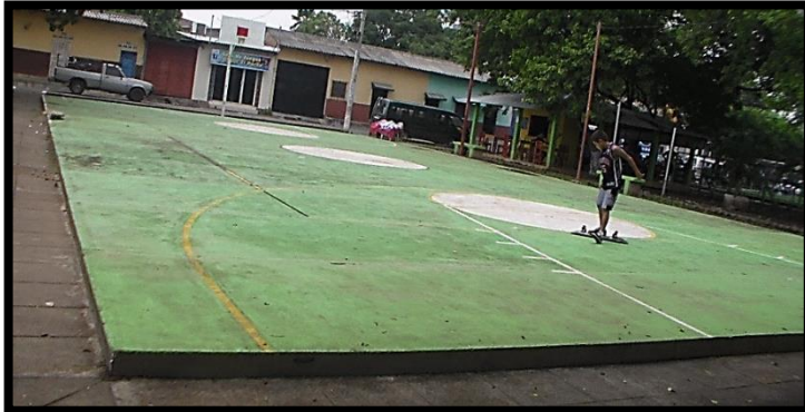
Cancha de basquetbol, en ella se observa el deterioro en el concreto y en la pintura
