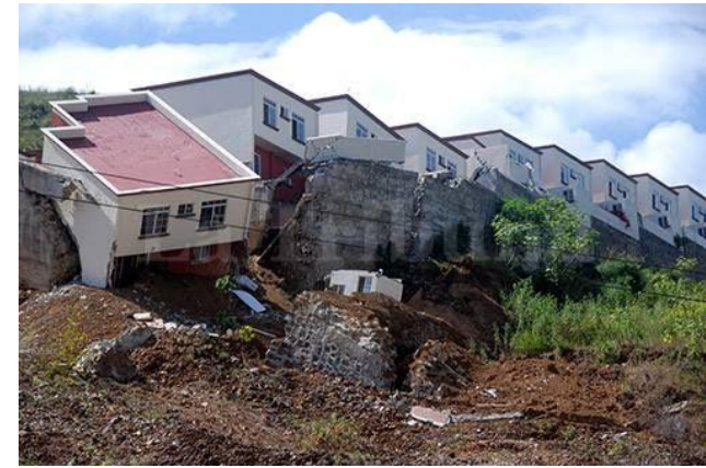
19. Hundimiento de tierra, Riesgo de construir sobre suelos inestables.
