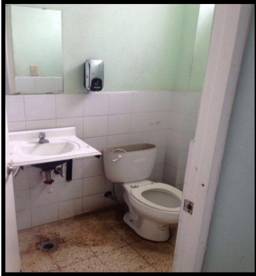
FOTO N°3 Espacio destinado para empleados donde puede observarse el abandono total a las instalaciones y los riesgos biológicos que se exponen.
