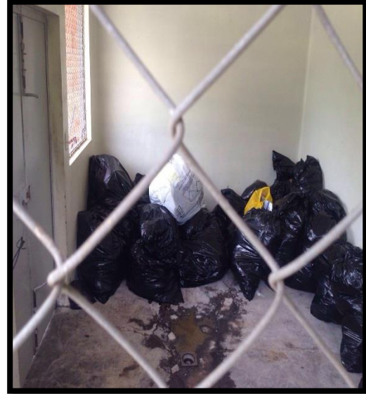
FOTO N°8 Inadecuada disposición de los desechos bioinfecciosos en condiciones que posibilitan un riesgo de contagio para personal y pacientes.
