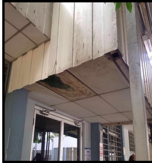
FOTO N°4 Grietas y humedales que evidencian el irrespeto a una serie de Sistemas de Gestión de Seguridad y Salud en el Trabajo.
