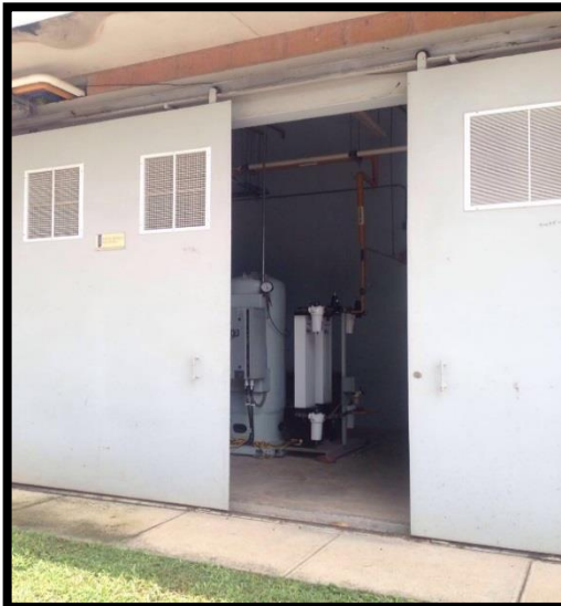
FOTO N°5 Equipo de electricidad, en total desprotección, constituyendo un riesgo para personal inexperto pudiendo causar fallos en el suministro.
