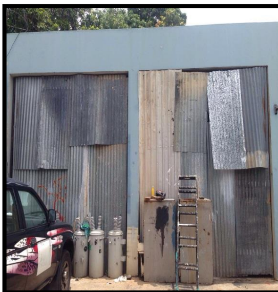
FOTO N°1 Instalaciones que funcionan como bodega y oficina de los motoristas del Hospital Nacional “Santa Teresa” Municipio de Zacatecoluca, es evidente el estado deplorable de las mismas
