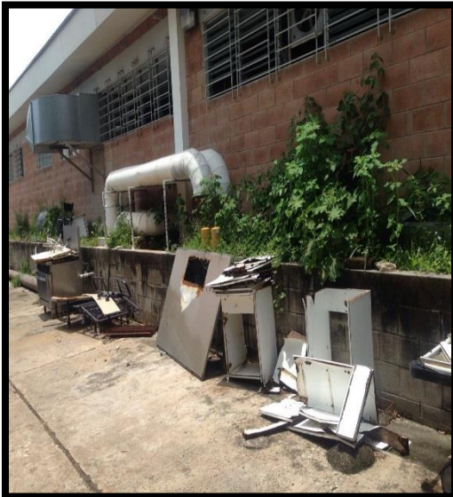
FOTO N°9 Mobiliario en desuso, dispuesto en áreas de paso pudiéndose generar fácilmente un accidente cuando una persona se traslade por este lugar.
