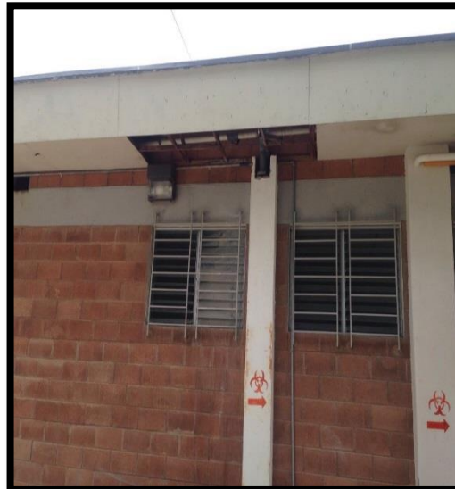
FOTO N°6 Señalética inadecuada para las instalaciones, ya que no indican de forma correcta el riesgo biológico al que se exponen los empleados que se asomen al lugar.
