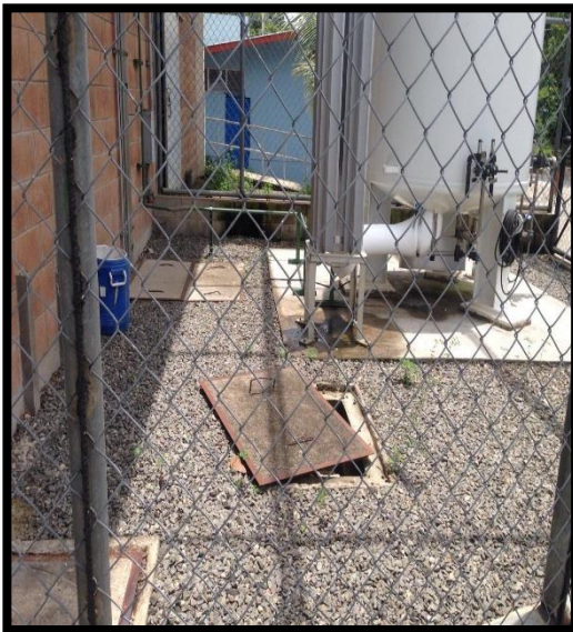
FOTO N°13 La rejilla no se encuentra a nivel del suelo por lo que puede ser causa de accidente pudiéndose generar un accidente cuando una persona se traslade por este.
