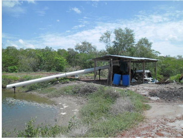
Figura A25. Bomba de abastecimiento para estanque reservorio.
