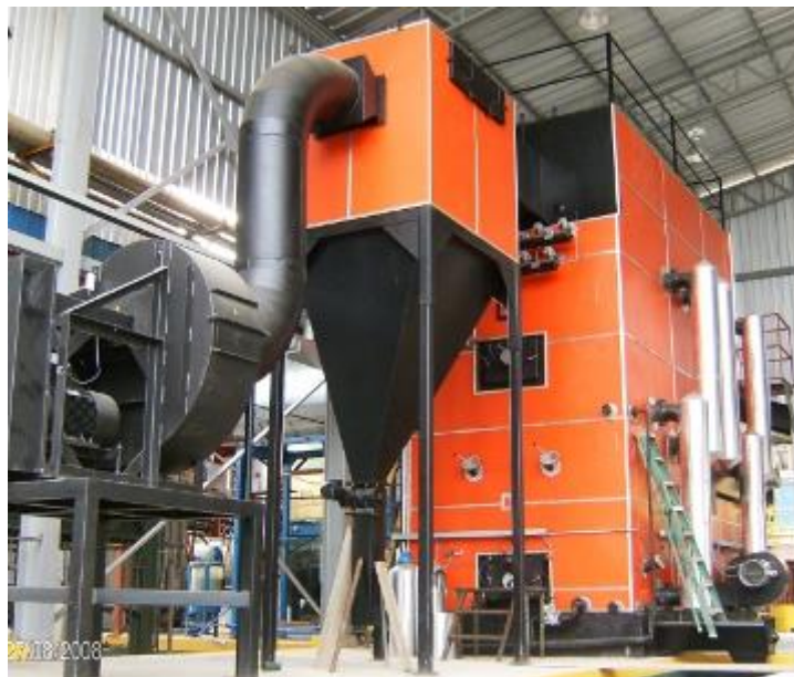
Figura 2.20. Caldera de Biomasa. Fuente: http://www.gruponovaenergia.com
