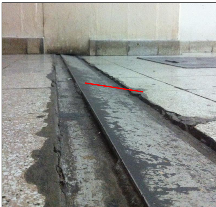
Figura IV-4: Junta de construcción que presenta diferencia entre los niveles de cada edificio. (Junta entre Ala Sur y Cuerpo Central)
