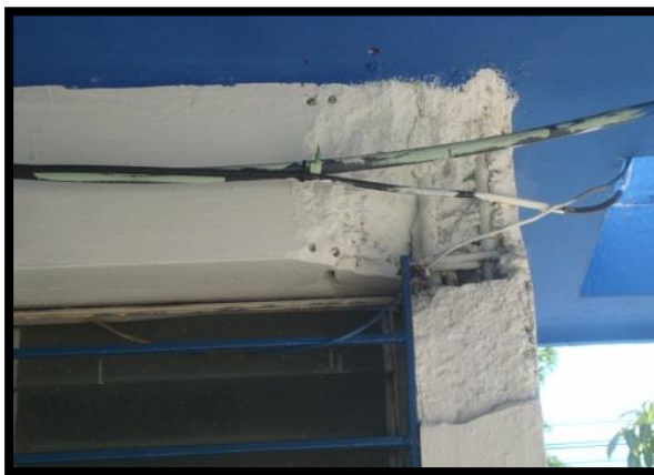
F-1. Deterioros en uniones de vigas y columnas. Fuente: propia
