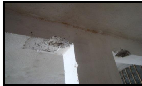
F-2. Daños estructurales en vigas de la planta baja. Fuente: propia
