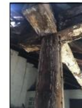
FISURA Y PRESENCIA DE ORGANISMOS EN VIGAS Y COLUMNAS
