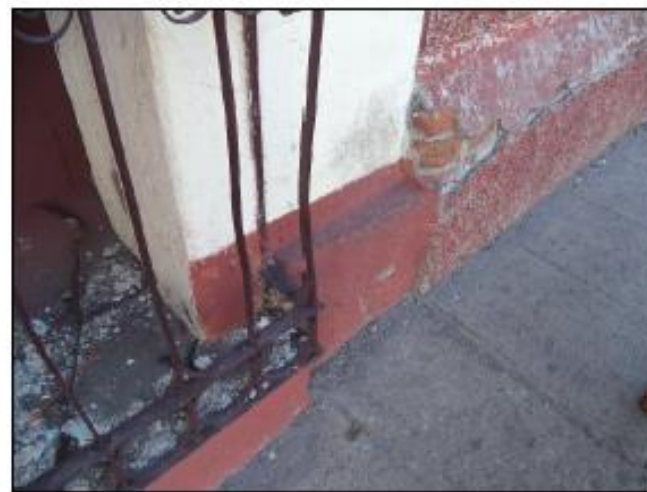
DAÑOS EN ELEVACIONES
