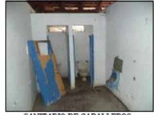
SANITARIO DE CABALLEROS PUERTAS FALTANTES
