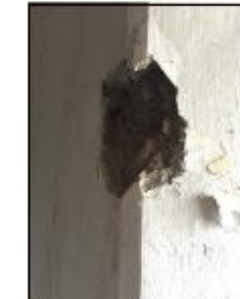
DESPRENDIMIENTO DE RECUBRIMIENTO
