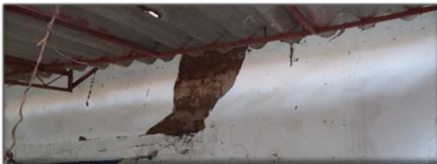
Imagen N°54: Desprendimiento del recubrimiento de la pared de Adobe.
