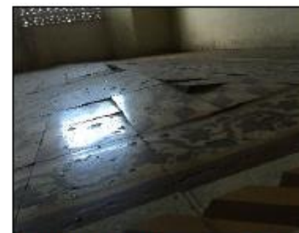
LEVANTAMIENTO DE SUELO CEMENTO PROVOCADO POR EROSIÓN DEL SUELO
