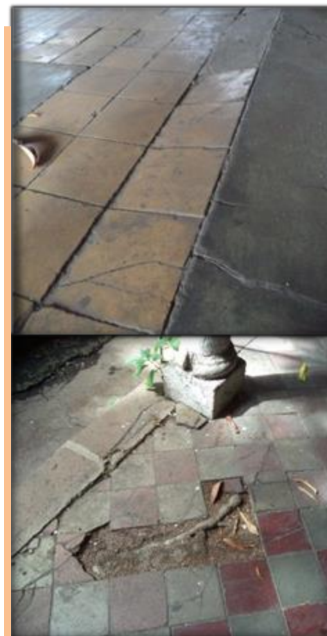
Imagen N°63: Suelo dañado y erosionado por raíces en Inmueble “C”.
