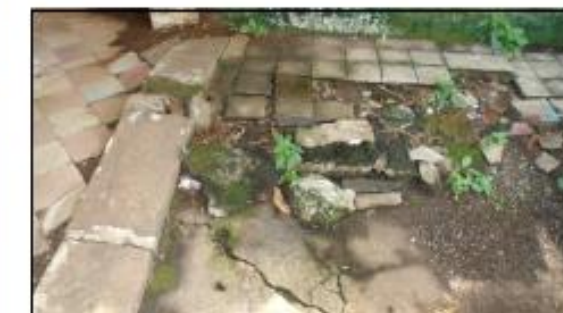
EROSIÓN Y FISURAS EN EL RECUBRIMIENTO DEL SUELO
