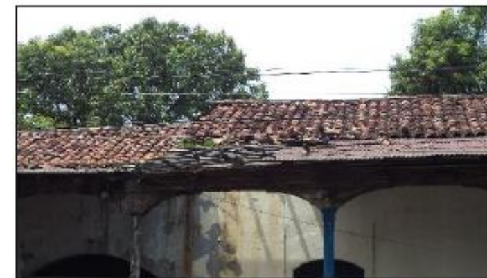
DAÑOS EN ELEVACIÓN NORTE
