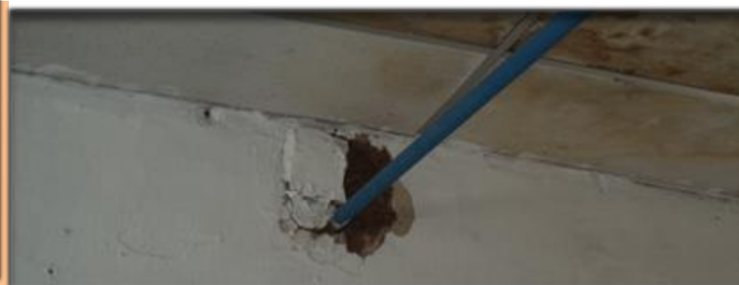
Imagen N°55: Daño en la pared de Adobe por mala instalación de empotrado.
