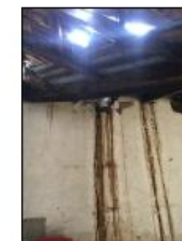
HUMEDAD Y FILTRACIONES
