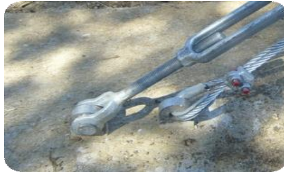
Imagen 71 - Anclaje del Canopy
