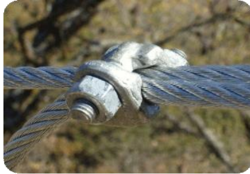
Imagen 73 - Sujeción de cable de canopy
