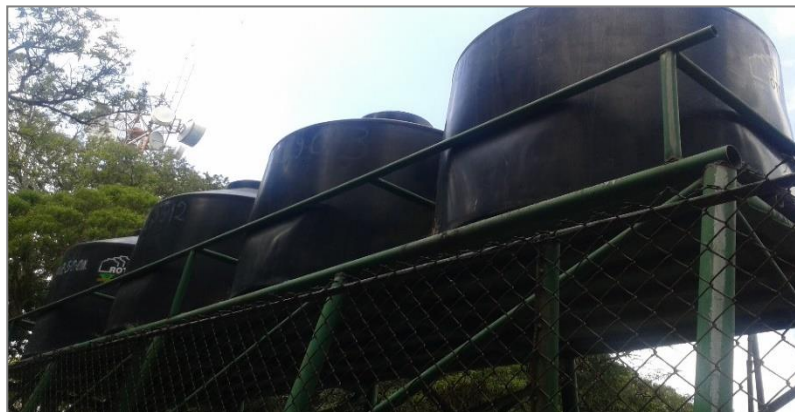
Imagen 20 - Tanques de captación de agua
